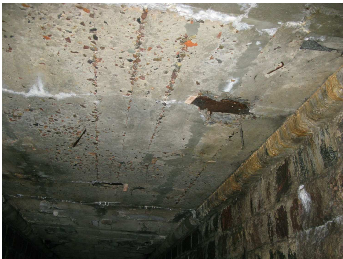
Fot. 4 Brak właściwej izolacji płyty pomostu
