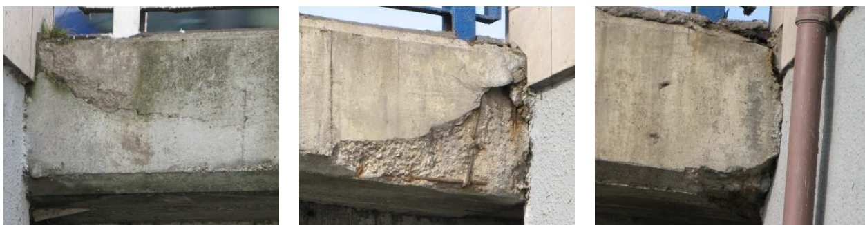
Fot. 14 Wegetacja roślin i mchów, pęknięcia gzymsu, ubytki betonu oraz korozja odsłoniętego zbrojenia, kolejno przeszła 8,7,6 od strony górnej wody
