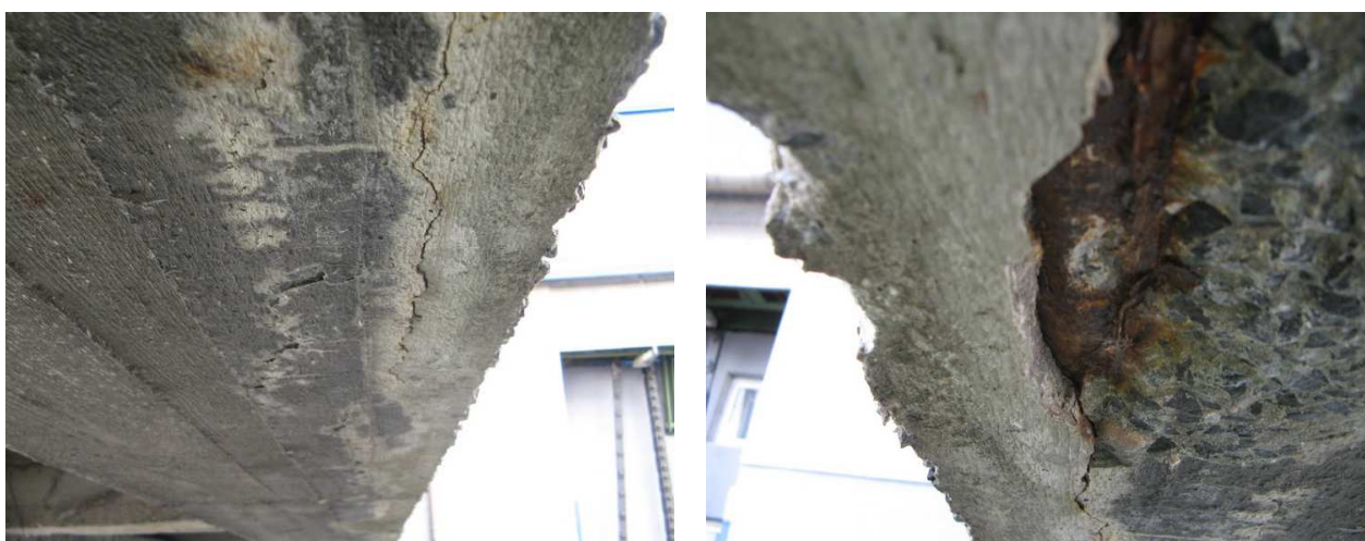
Fot. 53 Odspojenie otuliny kabla na całej długości belki (lewe zdjęcie), zaawansowana korozja osłonki oraz degradacja iniektu (prawe zdjęcie). Przeszło 4 dźwigar skrajny od strony górnej wody
