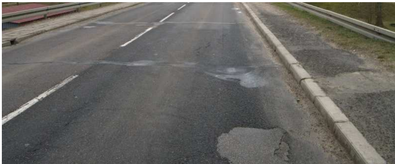
Fot. 5 Spękania oraz ubytki nawierzchni na dojeździe od strony Legionowa
