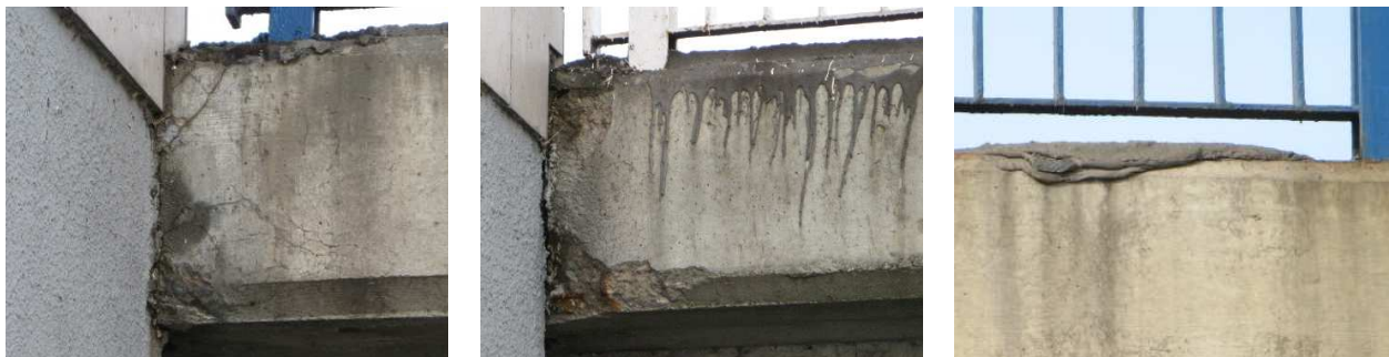
Fot. 15 Pęknięcia gzymsu, ubytki betonu, korozja odsłoniętego zbrojenia oraz spływ nawierzchni bitumicznej, kolejno przeszła 6,5,4 od strony górnej wody
