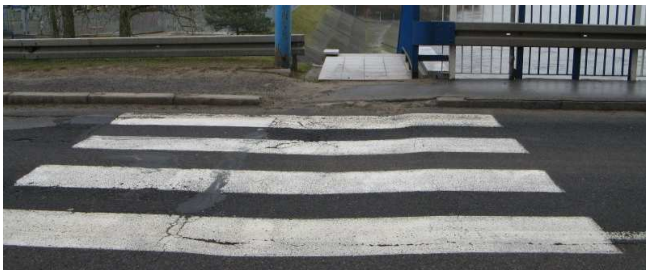
Fot. 6 Deformacja nawierzchni przy krawędzi obiektu spowodowana osiadaniami nasypu
