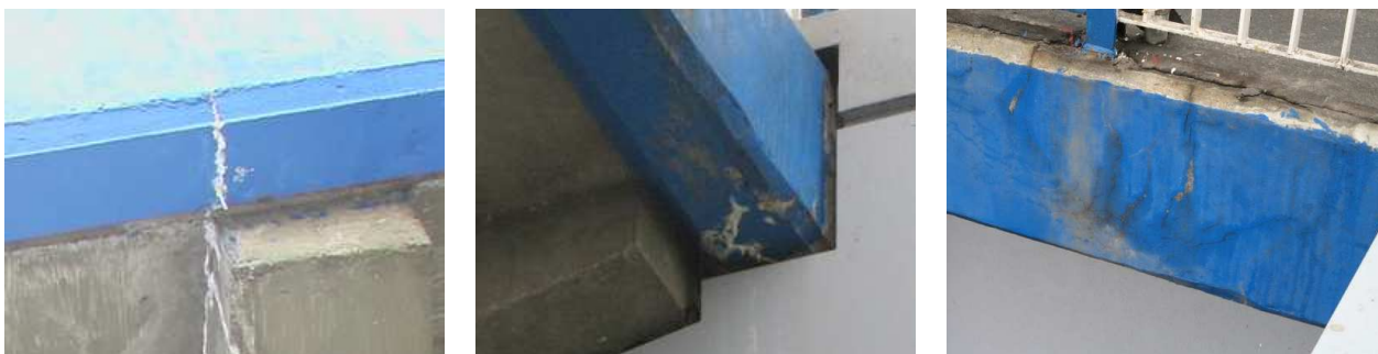
Fot. 16 Pęknięcia gzymsu obiektu na budynku elektrowni oraz krystaliczne wycieki (oba zdjęcia z prawej strony dotyczą krawędzi obiektu od strony Legionowa
