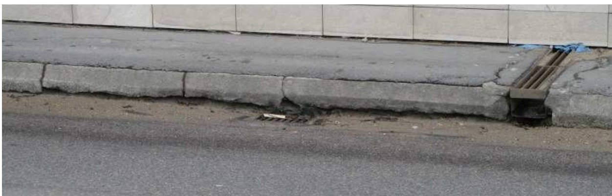
Fot. 10 Niedostateczna wysokość części krawężników kamiennych, ubytki krawężników przy rynnach spustowych wody z dachu
