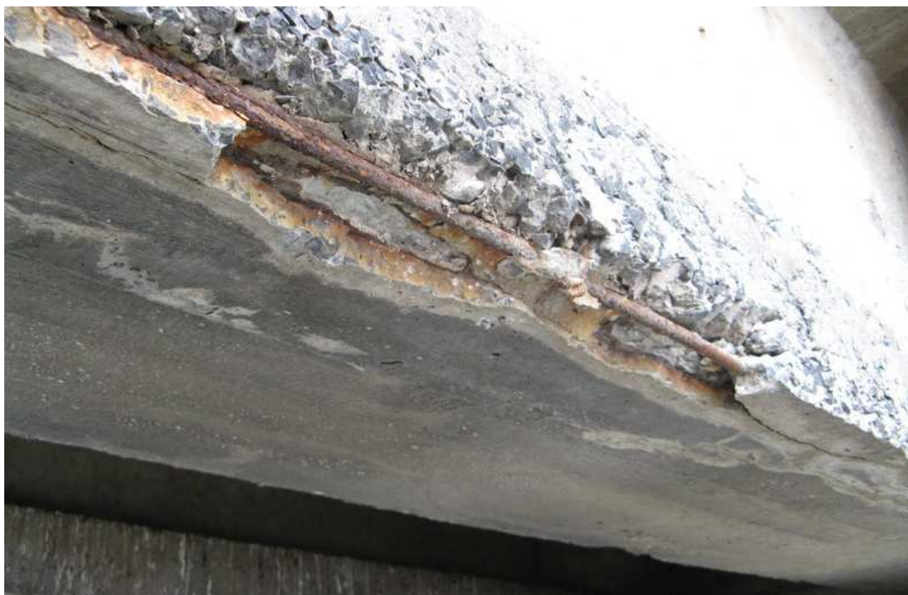
Fot. 54 Odspojenie otuliny kabla na znacznej długości belki, zaawansowana korozja osłonki oraz degradacja iniektu. Przeszło 6 dźwigar skrajny od strony górnej wody
