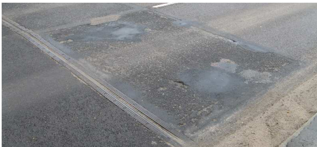
Fot. 7 Ubytki oraz ślady napraw nawierzchni przy skrajnej dylatacji od strony Nasielska, zalegający piasek wzdłuż krawężnika
