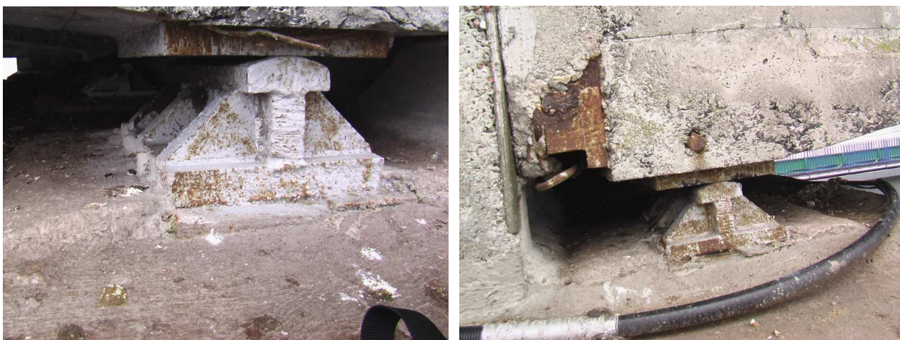
Fot. 17 Powierzchniowa korozja łożysk
