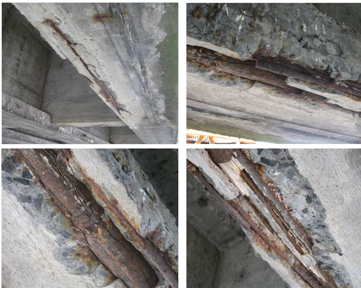
Fot. 52 Rozległy ubytek oraz odspojenie otuliny, zaawansowana korozja osłonki. Stwierdzono korozję strun kabla (zdjęcie w dolnym prawym rogu) oraz spękanie podłużne osłonki świadczące o spęcznieniu iniektu lub odkładaniu produktów korozji strun. Przeszło 4 dźwigar skrajny od strony dolnej wody
