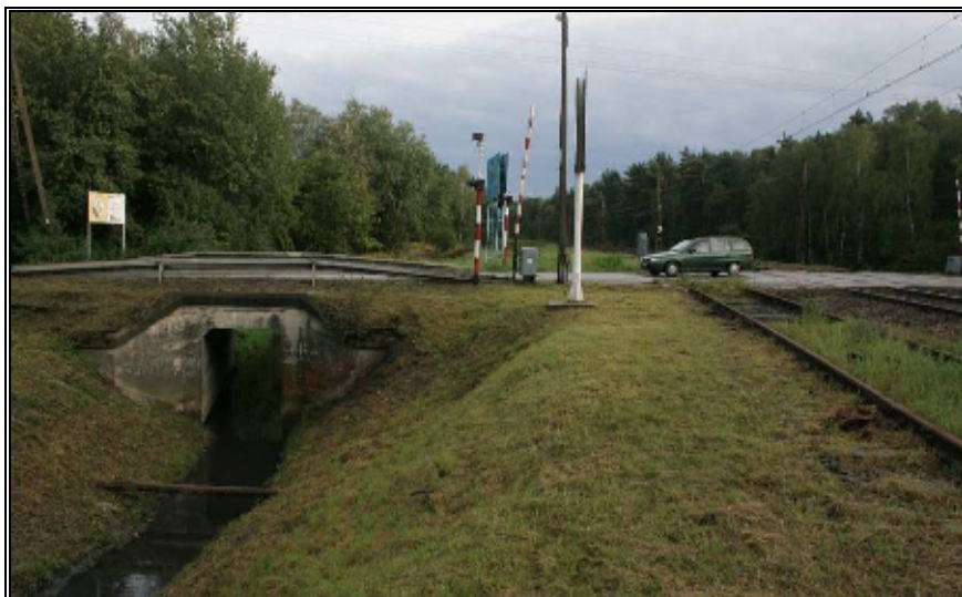
Fot nr 12. Dolina niewielkiego ciekę wodnego na km ok. 21+800. Widoczny brak typowej roślinności przybrzeżnej.
