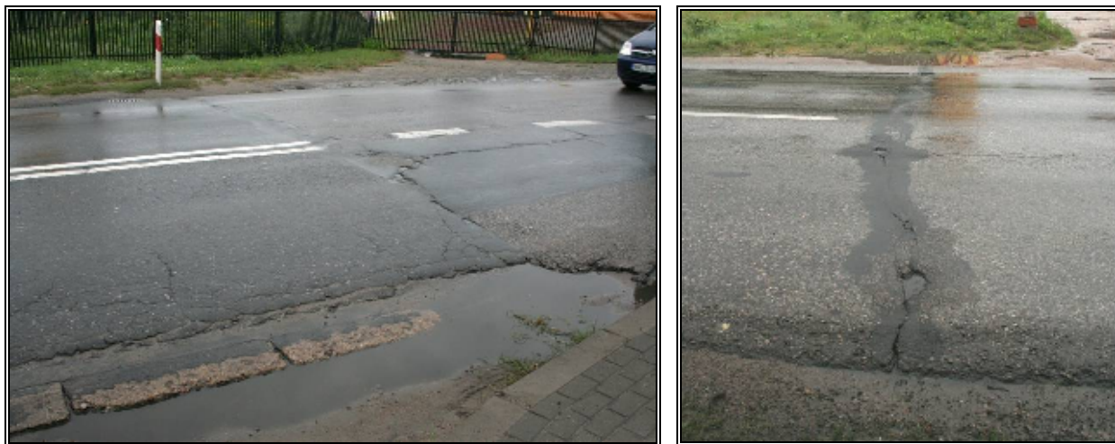
Fot 1, 2 Stan istniejącej nawierzchni asfaltowej na drodze wojewódzkiej nr 634 w km 25+700 (fot. 1) oraz w km 31+200 (fot. 2) Źródło: Opracowanie własne
