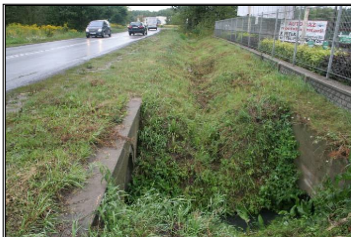
Fot. 3 Stan istniejącego odwodnienia powierzchniowego na drodze wojewódzkiej nr 634 w km 26+626
