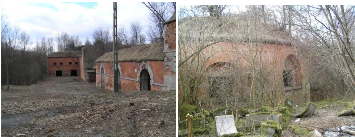
Fot. 5.17-18 Opuszczone forty Lunety Sowińskiego widziane od strony drogi krajowej nr 62 (od strony południowej). Budowla pozbawiona jest drzwi i okien, które znajdowały się jeszcze w obiektach pod koniec lat 90.
