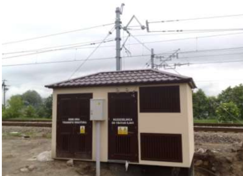
Fot. 33 – Stacja transformatorowa LPN, na stacji Modlin (E65)
