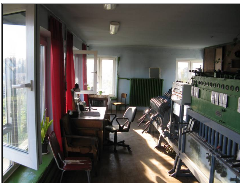
Fot. 19. Nastawnia wykonawcza w Radziwillowie - wnętrze
