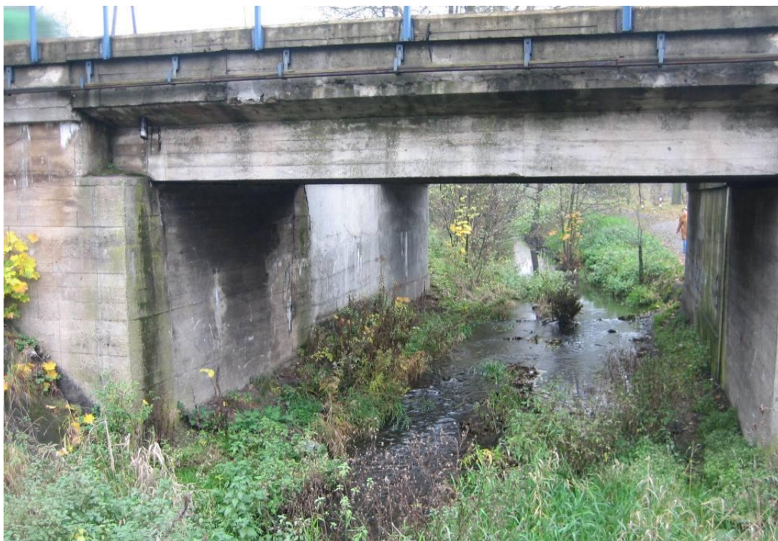
Zdj. 16. Most w km 43,784 – parametry i obudowa roślinna umożliwiają migrację średnich i małych zwierząt.
