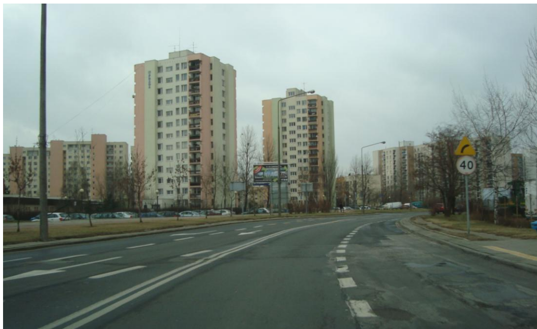
Rys. 5.8 Stan istniejący – niezadowolający stan nawierzchni jezdni
