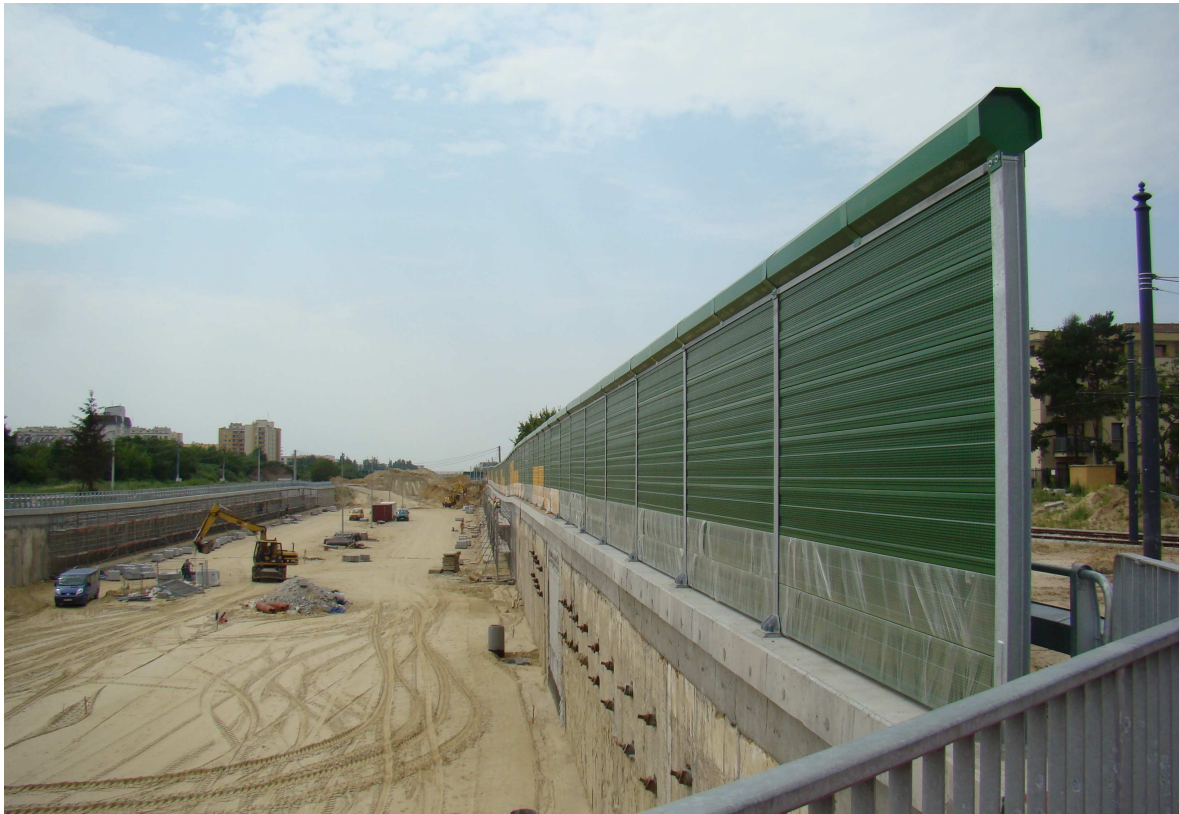
Fotografia 1 Ekrany z dyfraktorami na budowanej drodze S8 w Warszawie (sierpień 2010 r.)
