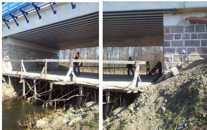
Fot. 1 Sposób zabezpieczenia koryta rzek przed zanieczyszczeniami w fazie budowy obiektu mostowego - tymczasowy podest ze szczelnie ułożonych desek na całej szerokości obiektu mostowego
