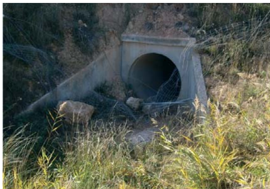
Rysunek 4.29. Przykład niewłaściwej konserwacji ogrodzenia wzdłuż drogi: część ogrodzenia przewróciła się i utrudnia dostęp do konstrukcji poprzecznej. Zdjęcie: Marc Fernández Bou.
