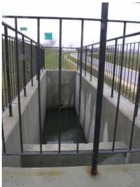
Fot. 4.1. Przykładowa konstrukcja piaskownika
