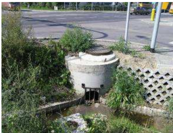
Fot. Z5.5. Osadnik do podczyszczania wód deszczowych
