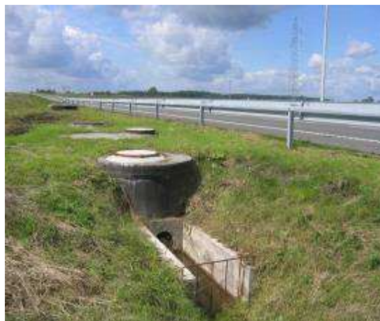
Fot. Z5.6. Osadnik w układzie podczyszczającym z separatorem
