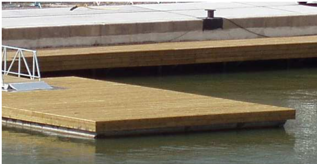
Rys. 3.3-3 Pomosty pływające na pływaku betonowym
